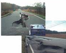
道路崩壊現場
